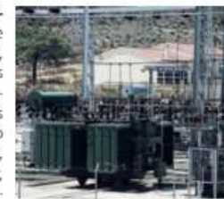
Transformador de subestación eléctrica.
